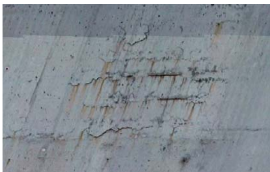
Fig.5. Detección de zona afectada, mediante el sistema Crack-View, a una distancia de 200 metros.
