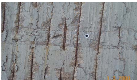
Fig.1. Corrosión de armaduras y estallido del hormigón circundante.
