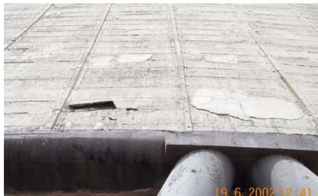
Fig.6. Aspecto de una Torre tras una reparación de 15 años. El 85% de los parches ejecutados con un determinado mortero, se desprenden. Todo el proceso se dejó en manos de un fabricante de productos de reparación.
