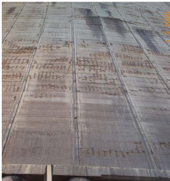
Fig.2. Aspecto de la lámina de un paramento cuando la corrosión de las armaduras se ha generalizado.
