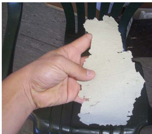
Fig.7. Ejemplo de especificación inadecuada de pintura para una Torre, aconsejada por un fabricante. La ejecución de ensayos no normalizados, pero significativos de las condiciones de trabajo, permitió cambiar la especificación.
