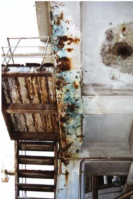
Figura 3. Proceso de corrosión bi-metálica en viga de hormigón armado.
