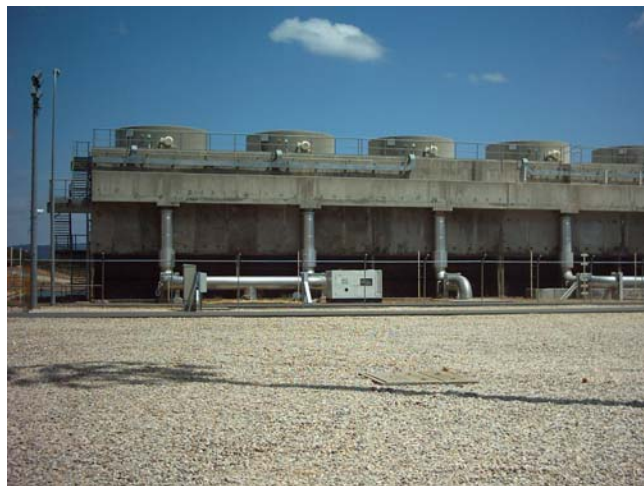
Figura 2. Vista general de una de las torres de refrigeración de tiro forzado.
