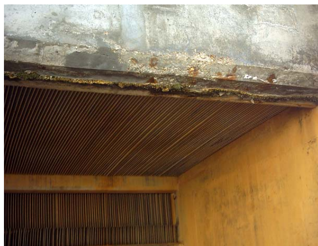
Figura 3. Corrosión de armaduras. Formación de materia vegetal y restos calcáreos
