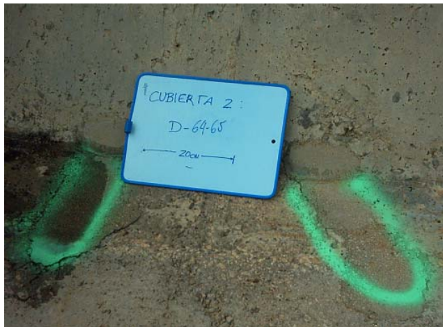
Figura 4. Catalogación y localización de defectos.
