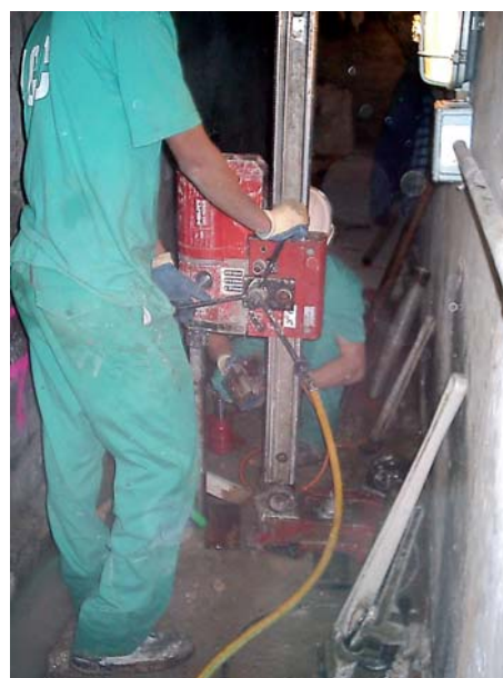
Figura 7. Equipo de trabajo en una galería de reducidas dimensiones. Tajo de la Encantada. ENDESA
