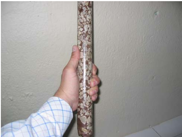
Testigo extraído a rotación de una zona de la prelosa una vez inyectada. Se aprecia que la resina (de color marrón), ha recompuesto el hormigón, ocupando el lugar de los finos arrastrados por el agua.
