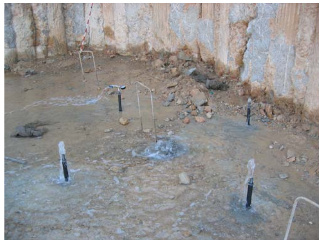
Aspecto de las surgencias a través de la prelosa. Se aprecian también cuatro obturadores colocados para realizar la inyección de la zona.
