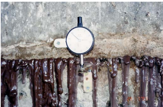
Figura 11. Resina saliendo por el paramento aguas arriba, tras rellenar una fisura. Se aprecia como el primer frente de material ha ido limpiando la fisura (color marrón), apareciendo la resina pura (gris), detrás. El reloj comparador se utiliza para medir los posibles movimientos de la estructura.
