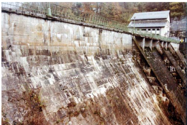
Figura 1. Paramento de presa afectado por reacciones expansivas
