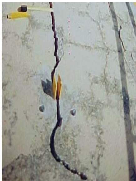
Figura 2. Fisuración tipo piel de cocodrilo y grietas en la coronación de una presa.
