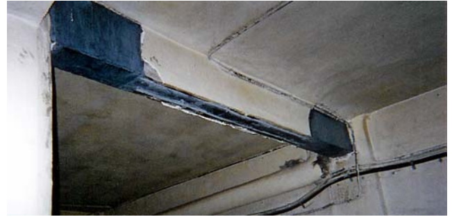
Figura 3. Refuerzo completo de una viga de un aparcamiento. Se aprecia la fibra aplicada como refuerzo de cortantes y el laminado para soportar las tracciones.
