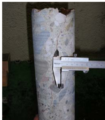
Figura 9. Testigo extraído de D = 100 mm donde se aprecia el resultado óptimo de la inyección ejecutada
