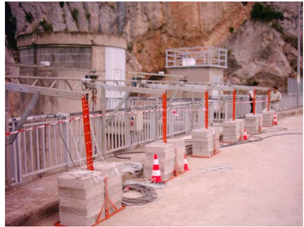
Figura 5. Pescantes señalizados del sistema de andamios colgantes motorizados aguas arriba de la presa
