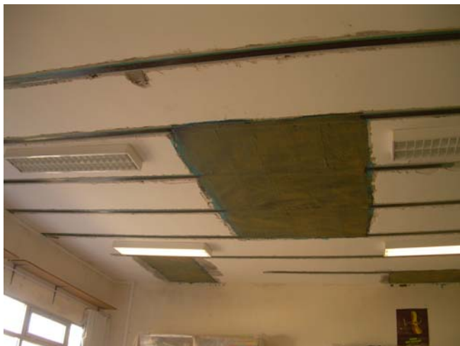
Fig. 14. Refuerzo de viguetas mediante laminado de fibra de carbono y resina epoxi.
