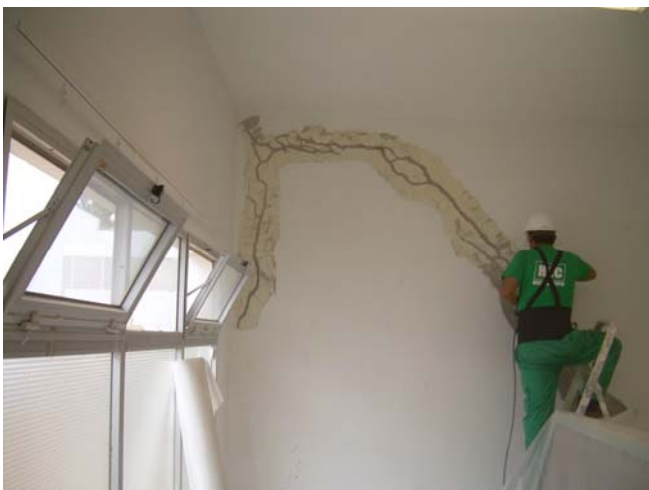
Fig. 5. Apertura de grietas en tabiquería.
